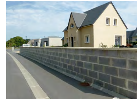
😞 Muret de clôture non enduit
