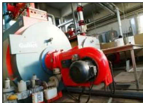
Chaufferie bois à Bayeux (Source : Commune de Bayeux)
